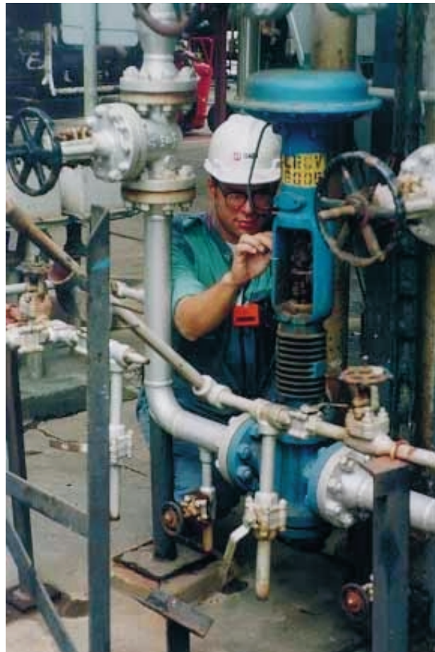
Monitoramento de haste de válvula.
