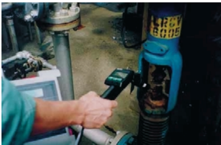
Detalhe do aparelho monitorando haste de válvula.
